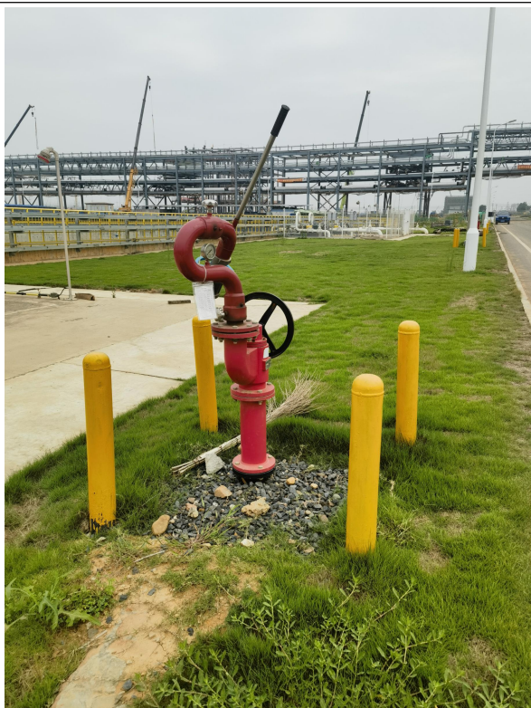
厂区周围消防栓
