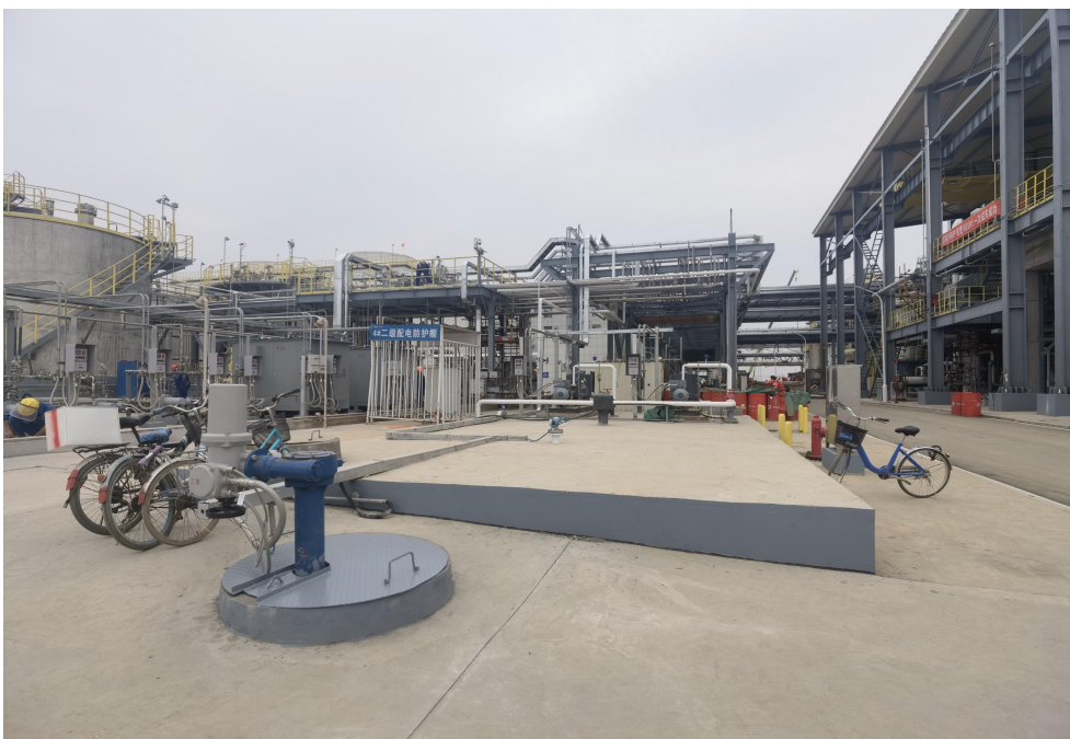
初期雨水池（地下）
