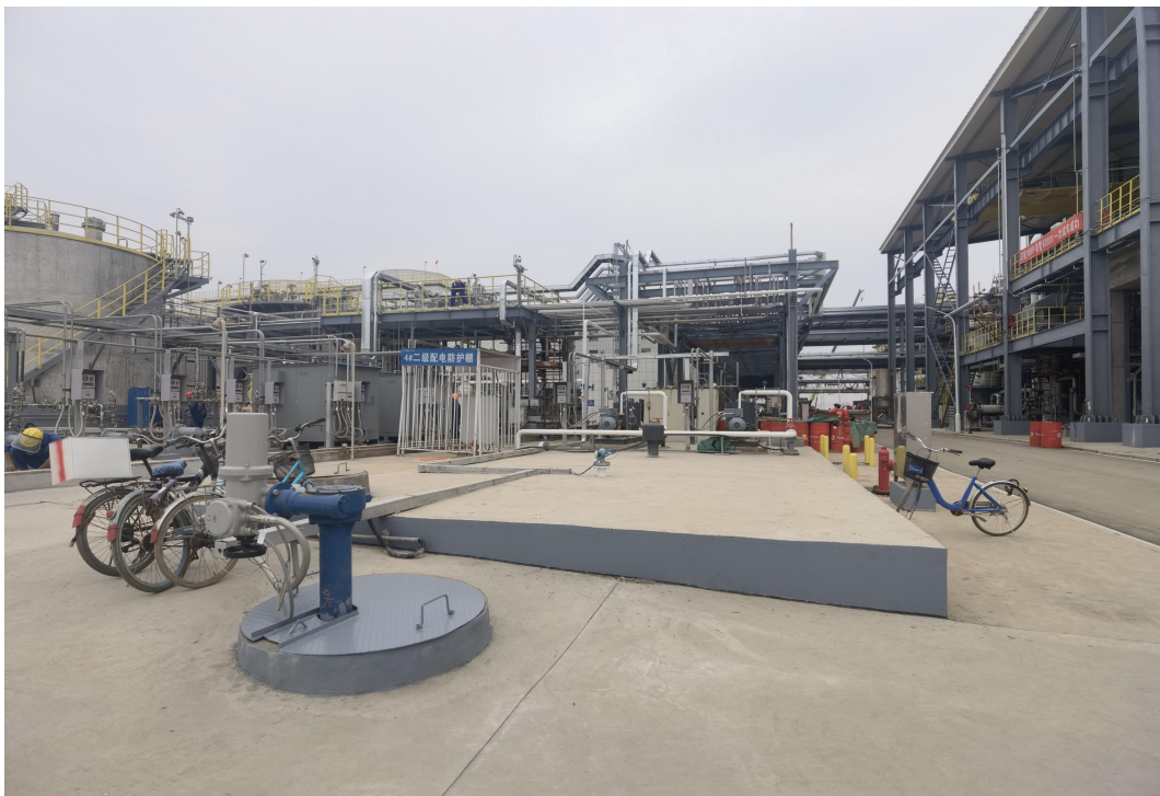
初期雨水池（地下）
