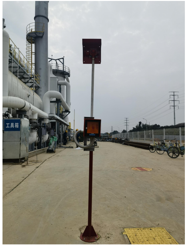
火灾报警器-罐区
