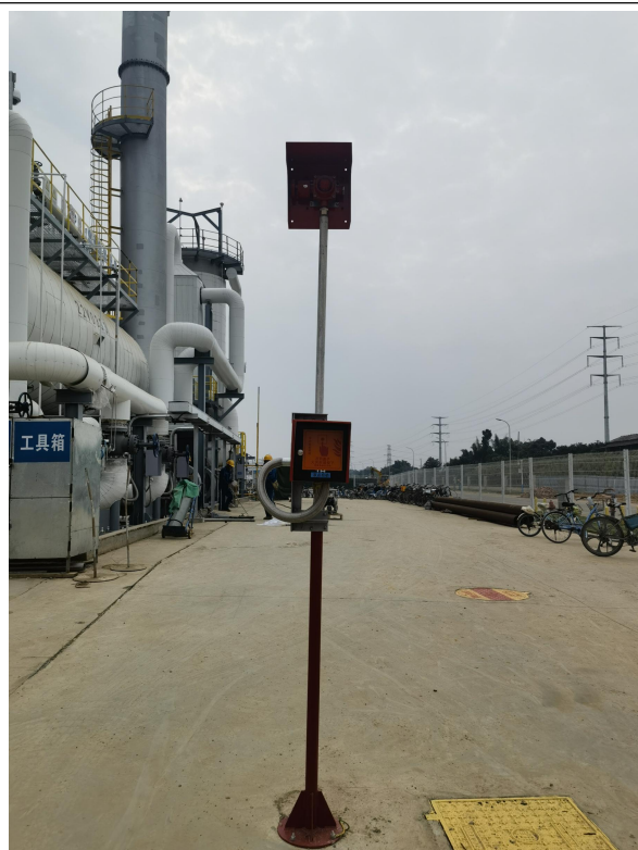
火灾报警器-罐区
