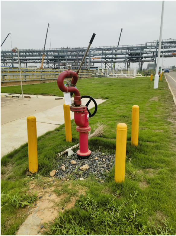
厂区周围消防栓
